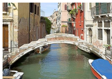
Ponte senza parapetto sul rio di S. Felice (ponte Chiodo)
